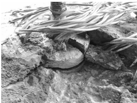
图9 锚杆拔出兼基体劈裂破坏
