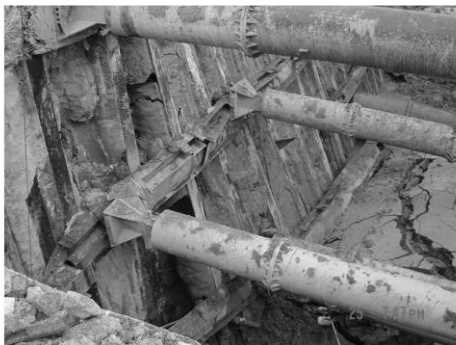
图2 基坑倒塌时型钢扭曲情况
