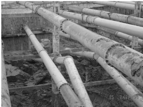
图1 某基坑工程事故情况
