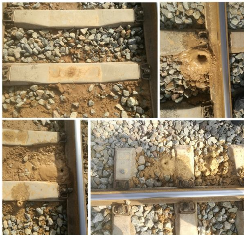
图 3 辛泰铁路典型翻浆冒泥病害
