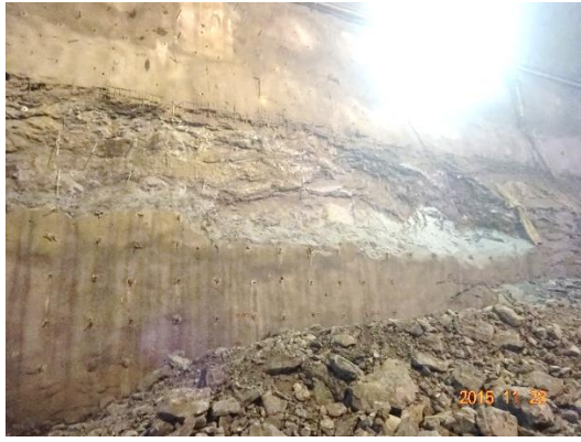
图 10 右岸地下厂房下游侧岩梁破裂破坏
