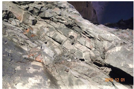
图 8 右岸尾水管检修闸门室下游侧底脚破裂面
