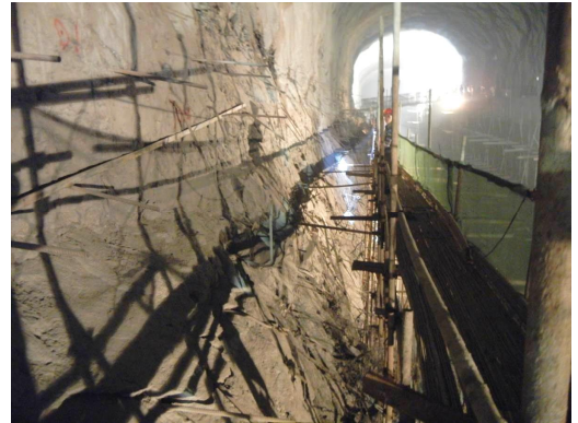
图 12 右岸尾水洞检修闸门室上游侧岩台梁块体破坏
