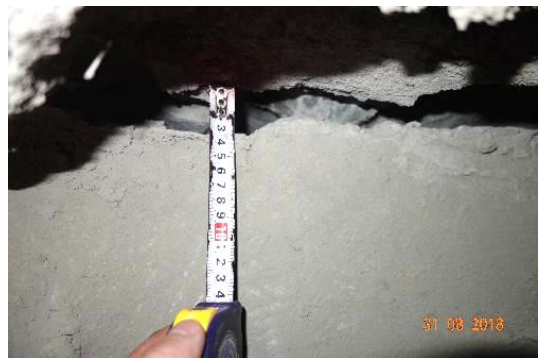
图5 右岸尾水管检修闸门室岩壁梁与边墙间裂缝
