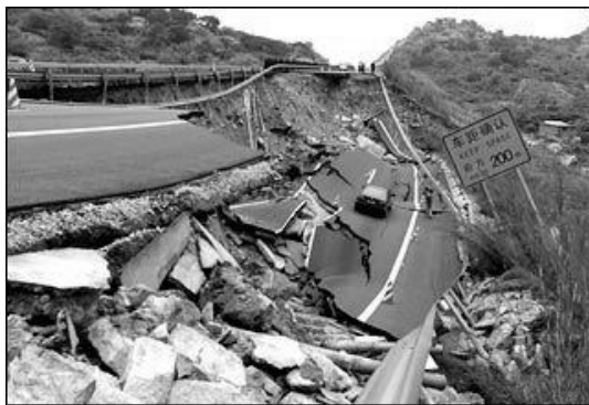
图1 路基滑塌案例
